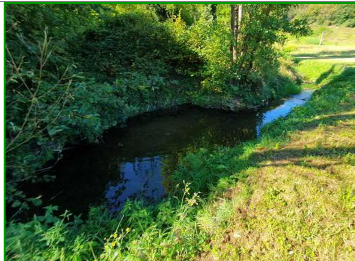
Slika 16. Potok Čučerska Reka – stacionaža km 0 + 410,00 – erozija lijeve obale (Izvor: Tau projekt d.o.o.)
