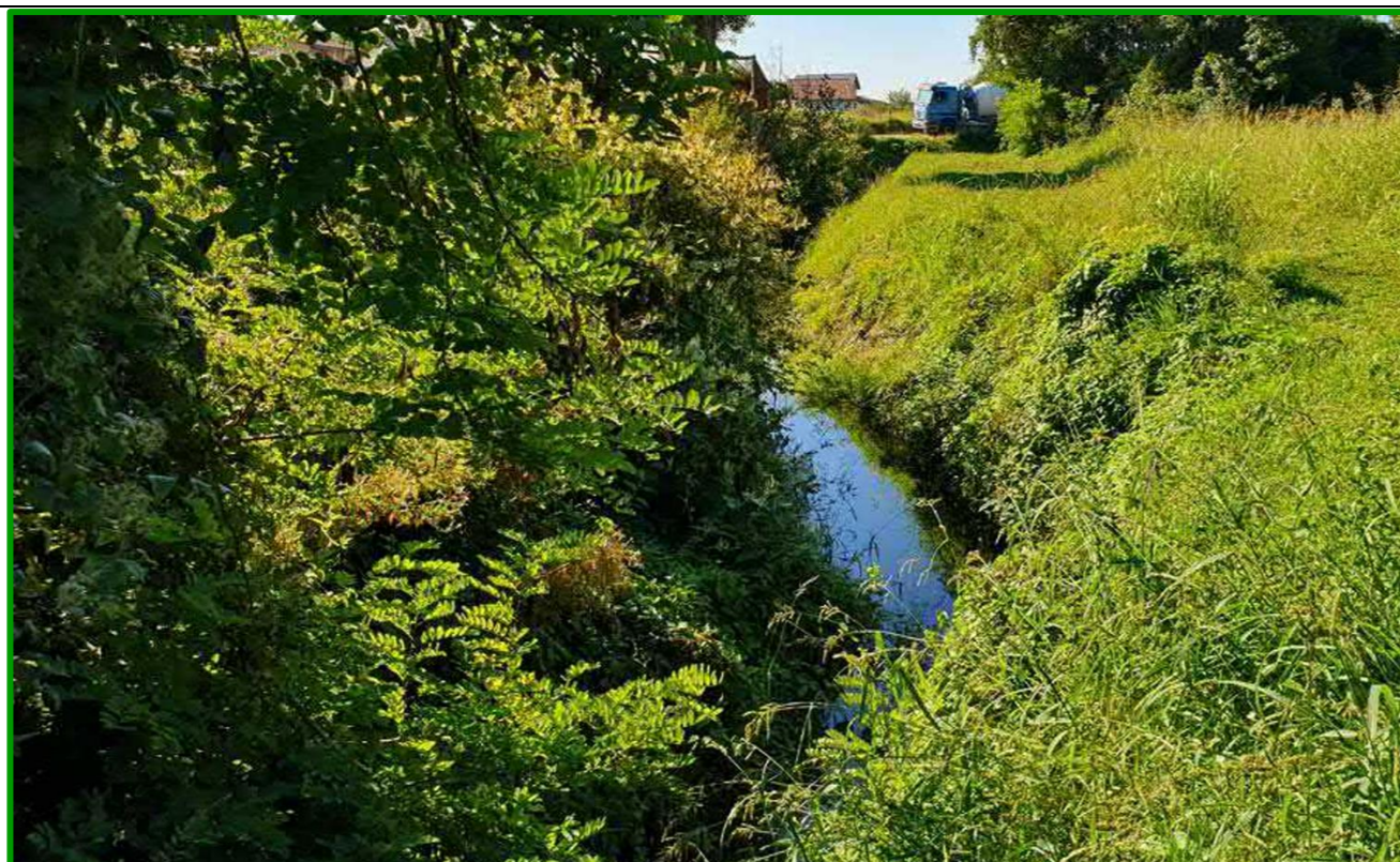
Slika 5. Potok Čučerska Reka – stacionaža oko km 0 +128,00 – 0 + 170,00 - erozija desne obale potoka (Izvor: Tau projekt d.o.o.)
