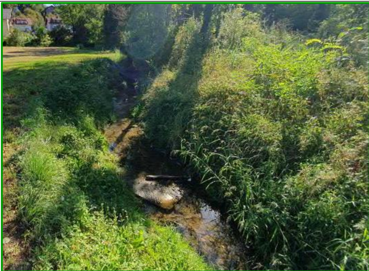
Slika 15. Potok Čučerska Reka – stacionaža od oko km 0 + 400,00 do km 0+420,00 – erozija obale potoka (Izvor: Tau projekt d.o.o.)
