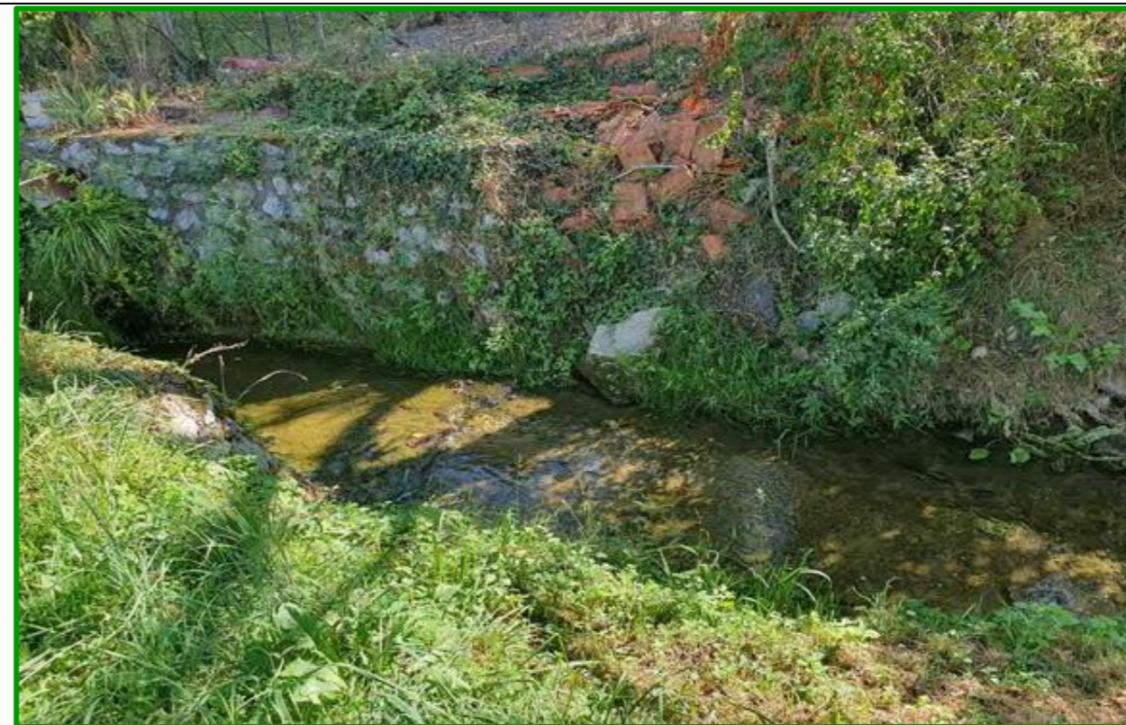
Slika 20. Potok Čučerska Reka – stacionaža km 0 + 480,00 – postojeća obloga korita (Izvor: Tau projekt d.o.o.)
